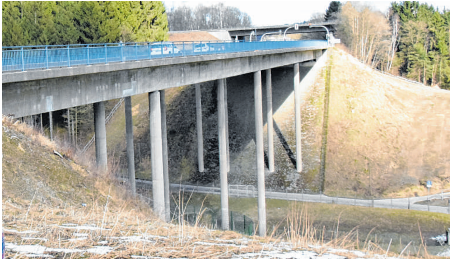
Die Talbrücke Öhringhausen wird vermutlich Ende April gesprengt. Karl-Josef Fischer, Pressesprecher des Landesbetriebs Straßenbau, geht davon aus, dass Interessierte vom Gewerbepark Huppcherhammer aus zusehen dürfen.
