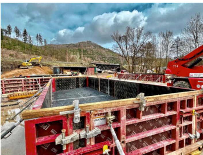
Auf dem riesigen Baustellengelände hinter dem Bahndamm entstehen die Schalungen für die riesigen Fundamente aus Beton, die hier vor Ort gegossen werden.
