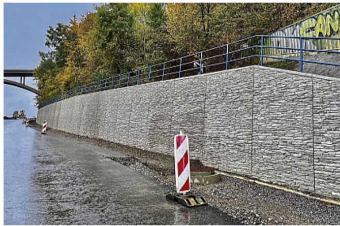
Eine neue Stützwand steht. Sie soll den sechsspürigen Ausbau der Autobahn sichern.
