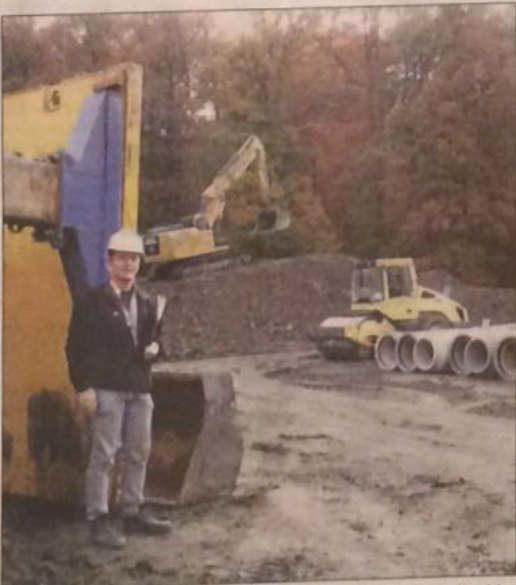
Die rund drei Meter hohen Stützwände, vor denen Dirk Fiedler hier steht, sollen für Sicherheit sorgen. Sie werden zusätzlich mit zwei Meter hohen Aufsätzen versehen. Zudem wird die parallel zur Talstraße liegende Grube abgeböschet.
